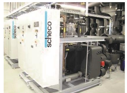
Kältemaschine der Firma Scheco
