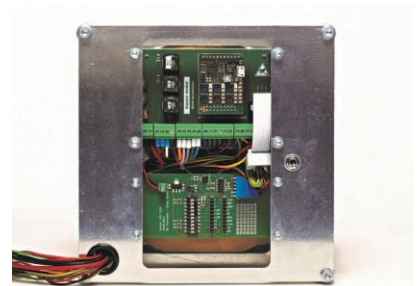
Oben befindet sich das Anschlussboard mit Controller für den EC-Motor, unten die selbstgefertigte Sensor Unit für die Winkelmessung.
