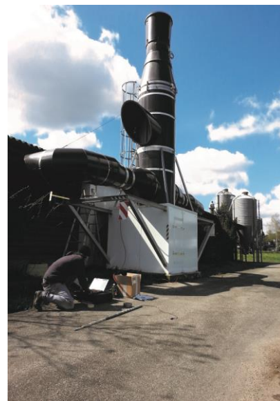
Messungen an der Wärmerückgewinnungsanlage bei Agroscope in Tänikon.
