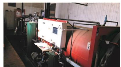
Kesseldruckimprägnieranlage mit Sicht auf die Schaltschränke
