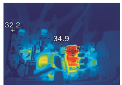
Die Messungen wurden mithilfe einer Wärmebildkamera durchgeführt, um Wärmeverluste auszumachen.
