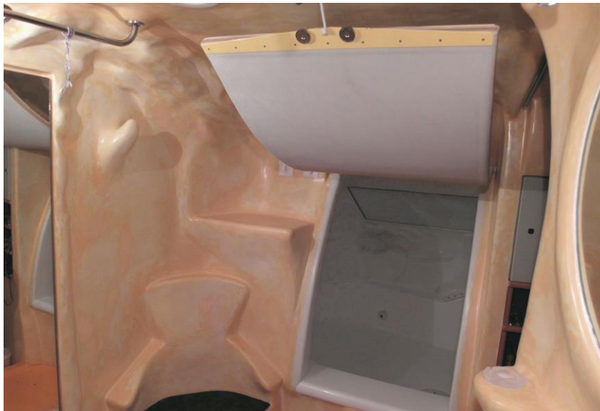
Das Bild zeigt den Vorraum zum Schwebabad, welches durch die momentane offene Luke betreten wird.
