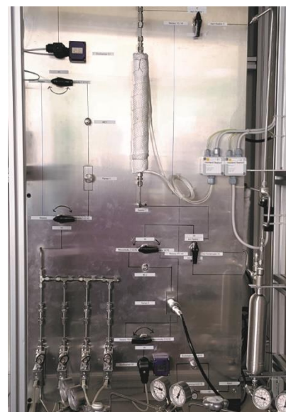
In Betrieb genommene Hochdruckanlage zur Methanolsynthese.
