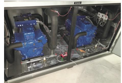
Zu optimierende Gebäudeanlage in Produktivumgebung ausgerüstet mit IoT-Gerät
