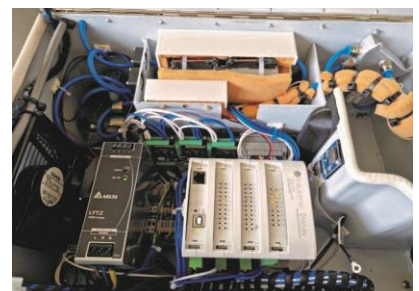
Gasanalysesystem mit Kondensationskammer zur Reduzierung der Luftfeuchtigkeit (hinten) und dazugehörige Stuerelektronik
