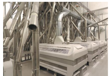
Zwischen den vier Maschinen und den Aspirationsleitungen wurden vier Volumenstromregler eingebaut, welche die Bedingungen für die Maschinen konstant halten können.
