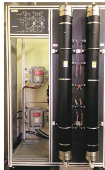
Thermal Swing Druckadsorptions- Anlage mit den beiden Adsorptionssäulen.
