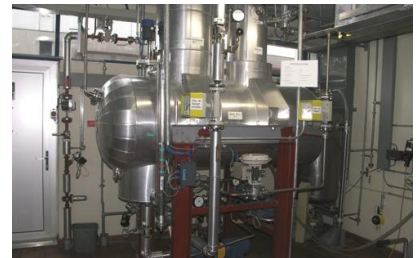
Labor für Verfahrenstechnik an der ZHW
